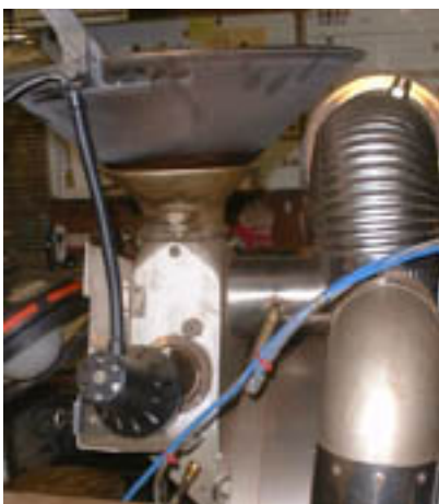
排気温度センサー 煙突部分ではかる
