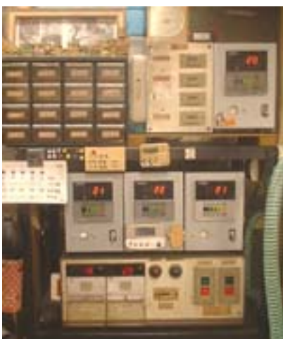
制御盤 中段3個の温度計が 比較温度計と廃熱温度計
